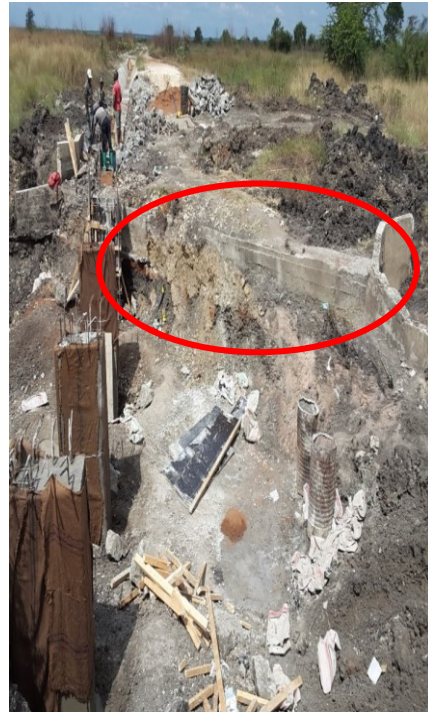
Photo 6.2: Kalvati lililoharibiwa na mvua (kwenye mduara mwekundu) na ujenzi wa vivushamaji vipya katika skimu ya umwagiliaji ya Wami-Luhindo. Uharibifu huu umechangiwa na kutofanyika kwa kipengele cha athari za mazingira. Picha imepigwa na mkaguzi tarehe 12 Julai 2018
